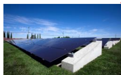
太阳能光伏 Solar Photovoltaic
