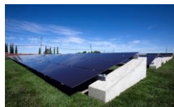
太阳能光伏 Solar Photovoltaic
